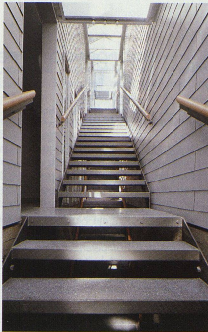
Die innere Erschliessung der Gebäude erfolgt über halbgesschossig versetzte Wohnungszugänge, die über ein Oberlicht natürlich belichtet sind.
