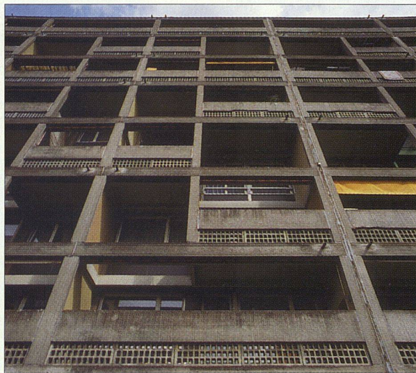
Vorher: eindeutig renovationsbedürftig ...
