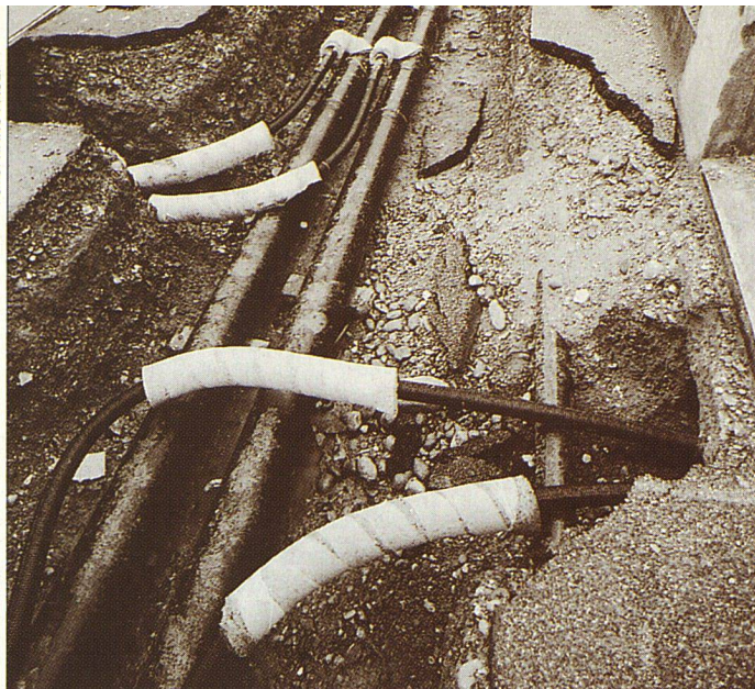
Die Kehrseite der zentralen Wärmeversorgung: Gräben und Wärmeleitungen sind teuer.
