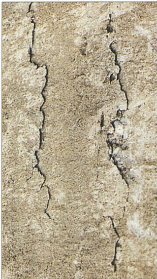
Entstehung von Rissen
