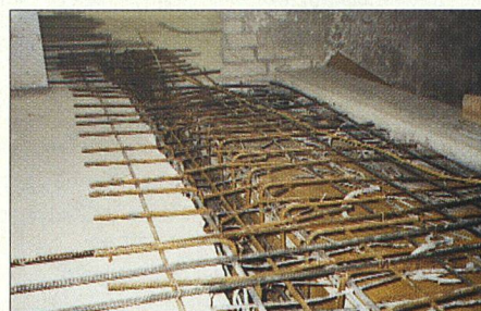
An dieser Stelle war die Betondecke nicht mehr zu gebrauchen. Die Schlämme des alten Holzzement-Unterlagsbodens schieden Salpetersäure aus, welche die Armierungseisen angegriffen hat.
