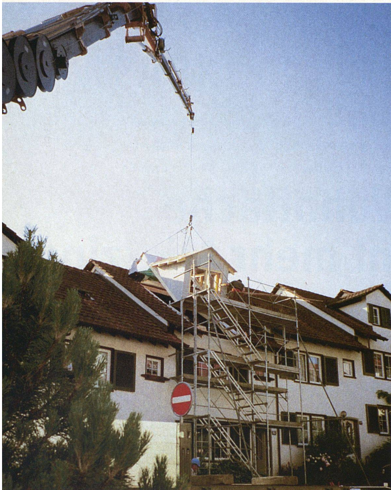
Kurze Bauzeit dank vorgefertigter Teile: Die fertigen Lukarnen setzt der Kran zielgenau aufs Dach.
