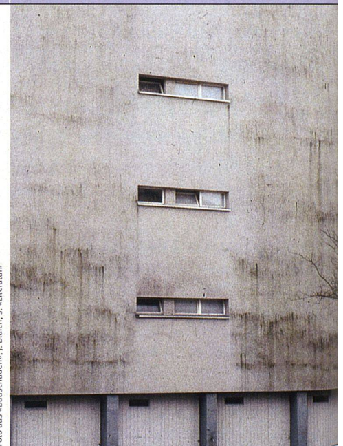
Foto aus «Bauschäden», J. Bläich, s. «Literatur»
