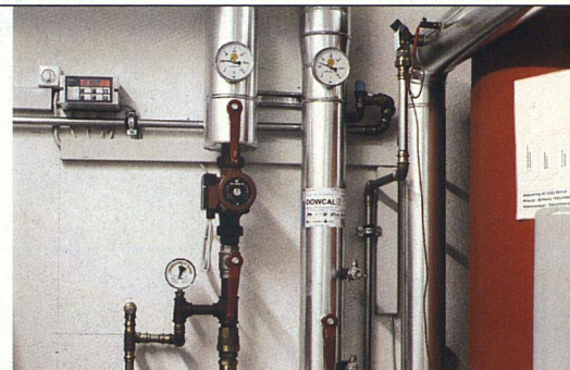
Über einen Wärmeaustauscher liefern die Sonnenkollektoren vorgewärmtes Wasser in die Boiler.
