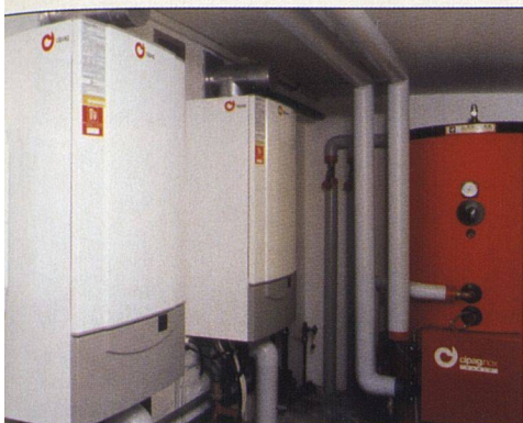
Dachzentrale mit zwei modulierenden 40-kW-Kondensations-Wandkesseln für fünf Wohnungen, Büros und Läden in einem sanierten Altbau in Vevey.
