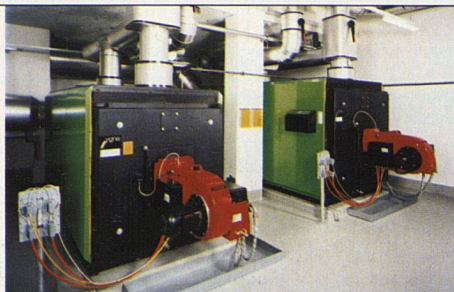
Moderne Heizzentrale für Wohnüberbauung mit «Multiflam»-Monoblockbrenner.
