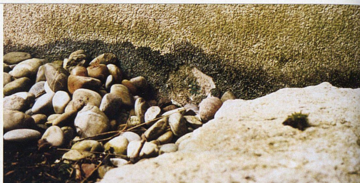
Diese Detailsicht zeigt neben dem Algenbefall auch tiefer gehende Feuchtigkeitsschäden.
