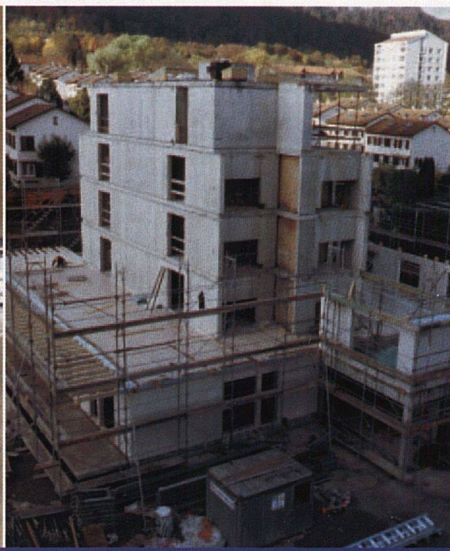
Die Siedlung Hegianwandweg während der Bauzeit. Der massive Kernbereich hebt sich vom Holzbau ab, wo die Wohnräume untergebracht sind. Die Struktur macht die freie Einteilung der Wohnungen möglich. Auf dem Bild rechts im Hintergrund FGZ-Reihenhausneubau.
