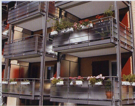
Die Betonböden sind mit Stahlwinkeln eingekleidet und bilden mit den Stützen eine Einheit.
