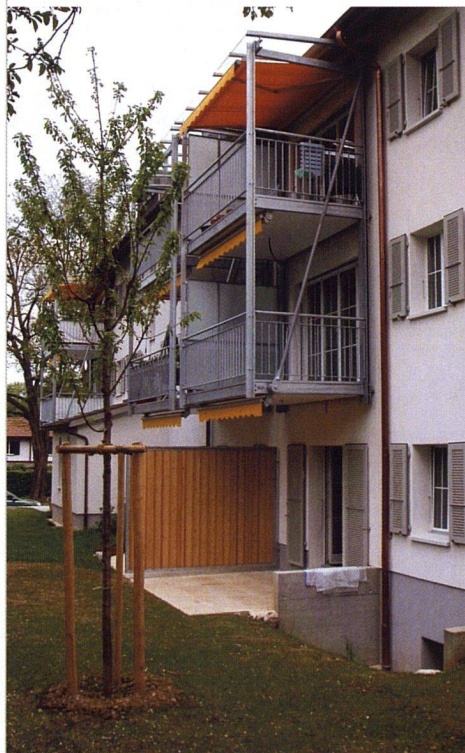
Die vorher in einer Nische versenkten Balkone wurden ganz nach aussen versetzt, so dass mehr Wohnfläche entstand. Die neuen Balkonkonstruktionen bieten zehn Quadratmeter Fläche. Wegen der Sonderbauvorschriften mussten sie über zwei Stockwerke aufgehängt werden.
