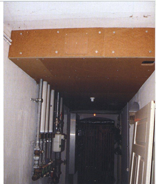
Die solide Kellerdeckenisolation dämmt die Erdgeschosswohnung.
