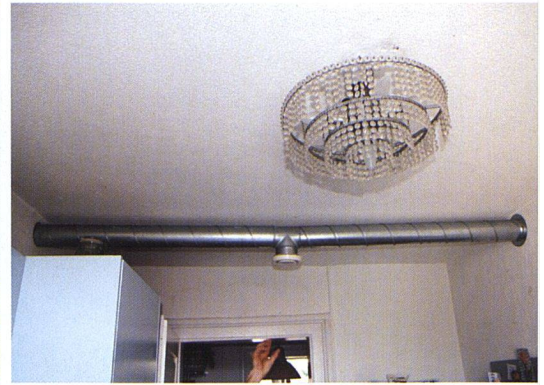
Stört die Bewohner nicht: sichtbares Abluftrohr in der Küche.
