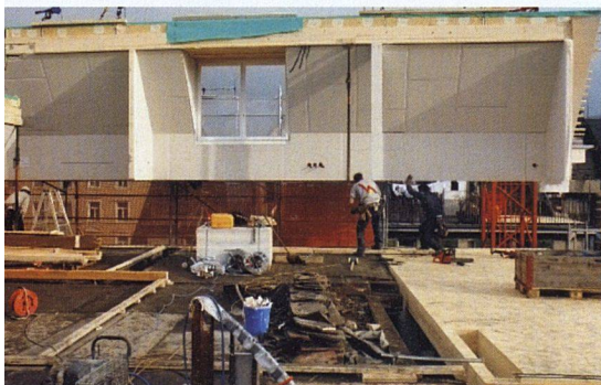
Die neuen Dachgeschosse wurden in Holzelementbauweise vorfabriziert und in einem einzigen Tag auf das Gebäude gesetzt.
