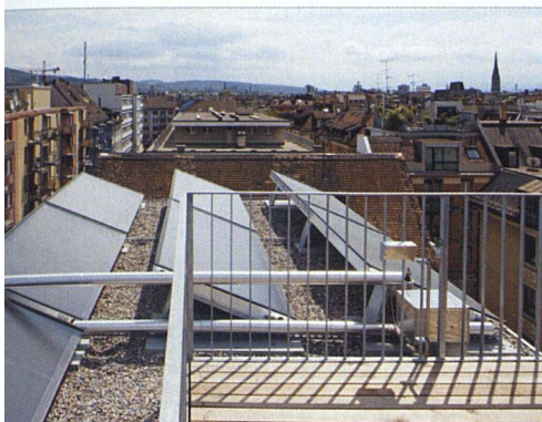
Sonnenkollektoren auf dem Dach erwärmen im Sommer bis zu 80 Prozent des Warmwassers.
