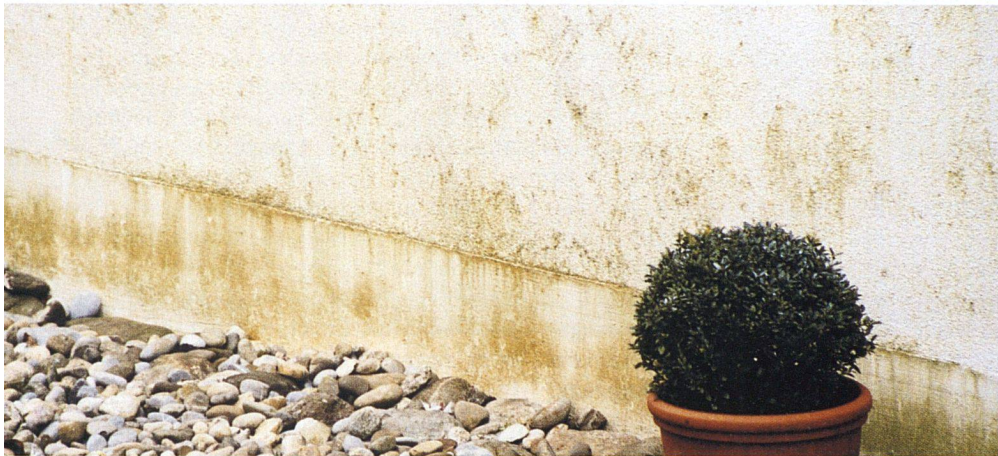
Algenbewuchs ist insbesondere bei gut gedämmten Fassaden ein Problem. Vom Einsatz von Fungiziden rät der Experte jedoch ab, da sie nicht mehr als eine Symptombekämpfung sind.
