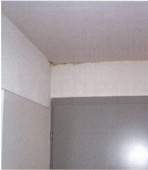
Hier löste eine mangelhafte Dampfbremse den Feuchtigkeitsschaden aus.
