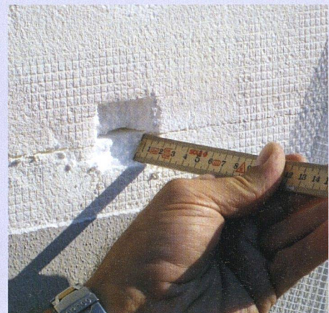
Vorsicht bei Kompaktfassaden: Massive Wärmeverluste und Schimmel können auftreten, wenn in Zwischenräumen Dampf kondensiert.
