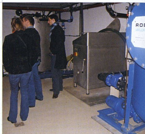
Organische Siedlungsabfälle gelangen in der Siedlung Flintenbreite in ein Mahlwerk (hinten, grau), WC-Abwässer in eine Vakuumanlage (rechts, blau).
