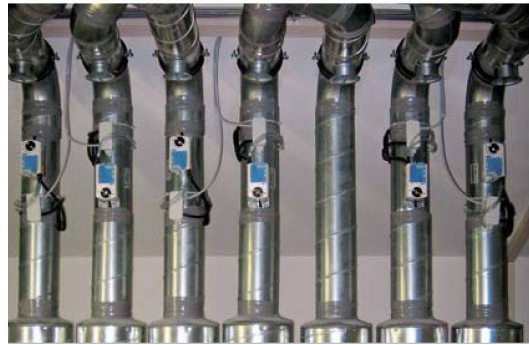
Im Dachstock wurde ein Technikraum für die zentrale Lüftungsanlage eingerichtet.
