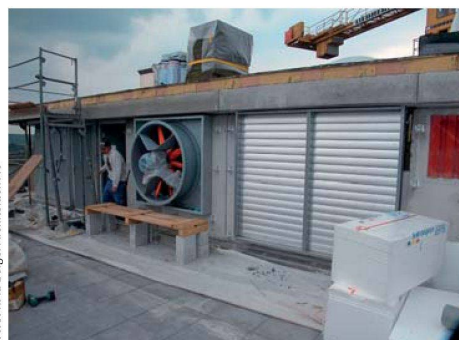
Mächtige Ventilatoren drängen im Brandfall den Rauch aus dem Treppenhaus.
