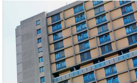
Die Leichtbauteile an der Nordfassade versah man mit Brandschutzplatten, Dämmungen und einer neuen Verkleidung.
