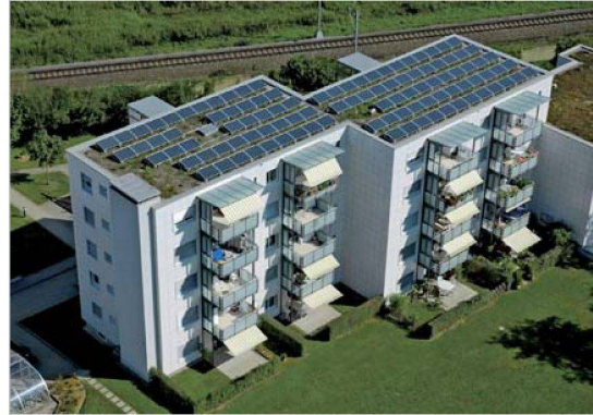
Photovoltaikanlage in der ASIG-Siedlung Holzerhud in Zürich Affoltern.
