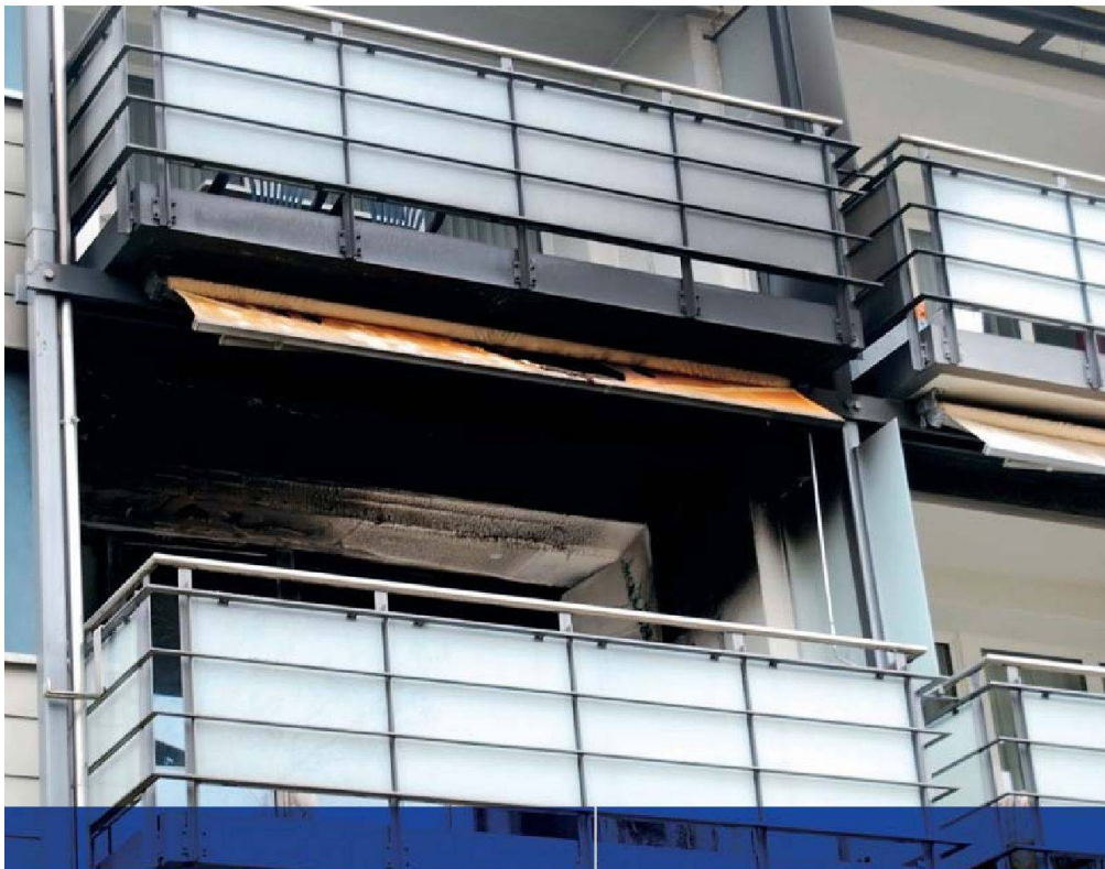
So präsentierte sich der Balkon der Rümlanger ASIG-Wohnung nach dem Brandfall. Ein Kurzschluss an einem Elektrogerät hatte ihn ausgelöst.
