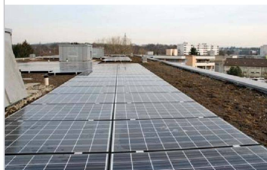
Die Photovoltaikanlage auf dem Dach der GBZ-Siedlung Luegisland versorgt zehn Haushalte mit Strom.
