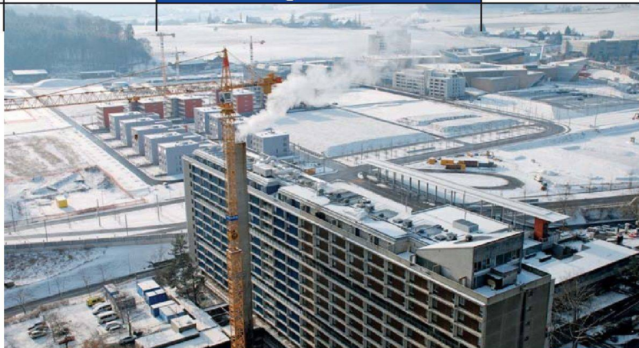
Block A wiederum mit bereits erneuerter linker Gebäudehälfte. Im Hintergrund das heranwachsende Quartier Brünnen mit Siedlungen der FAMBAU (rot), der Baugenossenschaft Brünnen-Eichholz (grau) sowie dem Einkaufszentrum Westside (rechts oben).
