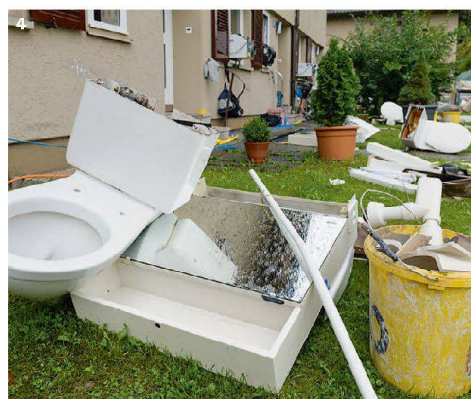
1 Gigantische Mengen an Schutt fallen beim Abbruch an. Die Bilder stammen von den Abbrucharbeiten für die Neubausiedlung «Living 11» der ASIG.
