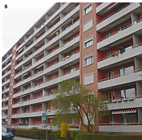
4 Grundrissplan: Die neuen Elemente sind rot eingezeichnet. 5 Die frühere Fassade mit den bescheidenen Balkonen.
