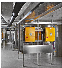
Titelbild: Wechselrichter der Wärmepumpe in der Kolonie Bändli. EWZ hat die Anlage im Contracting für die Baugenossenschaft des eidgenössischen Personals (BEP) erstellt.
