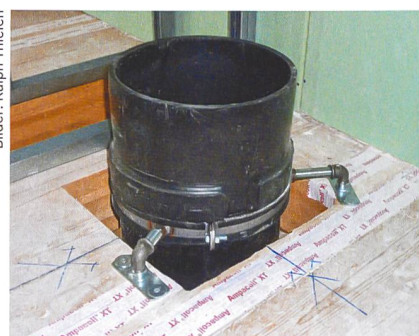
Der Nachteil dieses Systems: Die Abflussrohre brauchen mit einem 30-Zentimeter-Durchmesser viel Platz.
