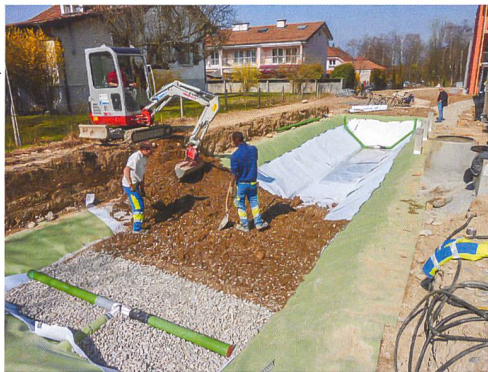
Für die Reinigung des Abwassers aus Küche und Bad legte man bei der Überbauung Cressy eine Pflanzenkläranlage an.
