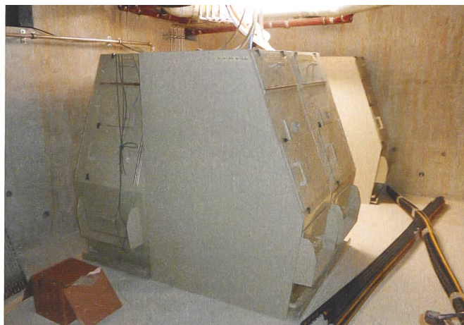
Hier wird aber nicht mit Wasser gespült. Vielmehr landen Fäkalien und Urin über ein Rohr direkt in einem Kompostierbehälter im Keller.
