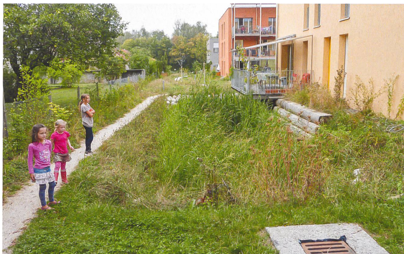
Die Pflanzenkläranlage fügt sich ins grüne Umfeld ein.
