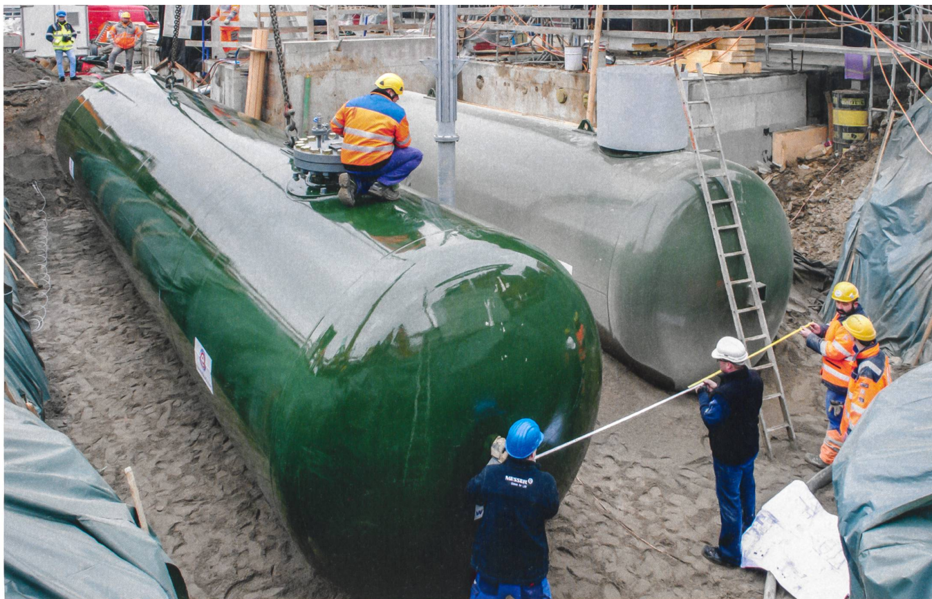
Beim energieautarken Mehrfamilienhaus in Brütten (ZH) wird überschüssiger Solarstrom in Wasserstofftanks gespeichert, sobald die Lithiumbatterien voll sind. Das Bild zeigt das Einsetzen der Tanks in den Boden.
