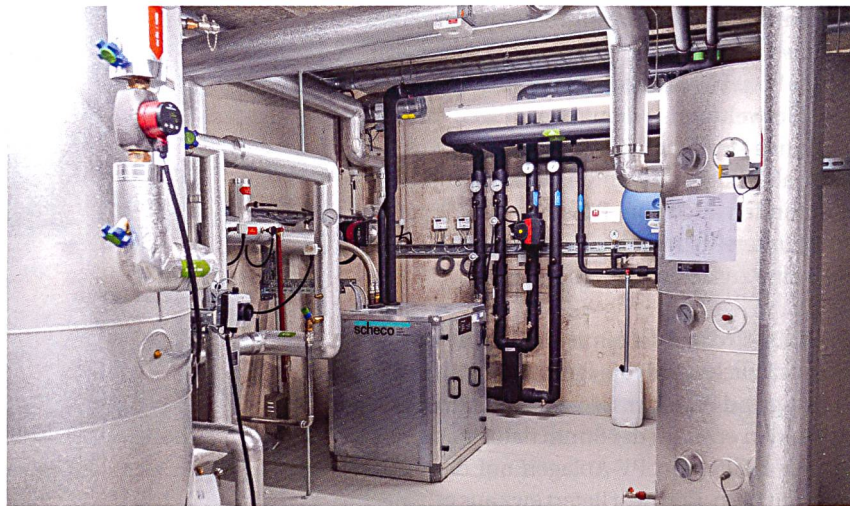
ewz-Projektleiter Pascal Leumann erklärt die verschiedenen Anlagen. Auf dem Bild links sind die schwarzen Erdsondenanschlussleitungen zu sehen, oben Warmwasserspeicher, Wärmepumpe und Pufferspeicher (von links).
