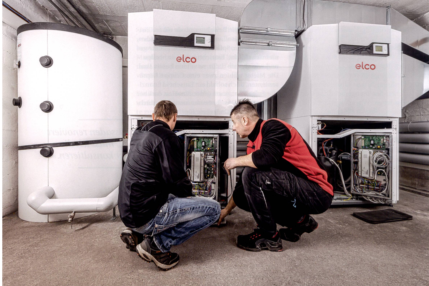
Inbetriebnahme einer neuen Heizung mit zwei Luft-Wasser-Wärmepumpen in Kriens (LU). Das Mehrfamilienhaus (Bild auf der rechten Seite) wurde zuvor mit Gas beheizt.
