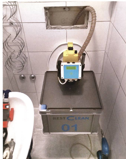
Abb.) RESTCLEAN Reinigungsgerät auf WC während Prozess
