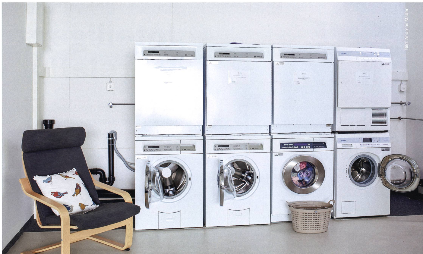
Mehr Gemütlichkeit in der Waschküche – ein Anliegen so mancher Baugenossenschaft (Bild: Waschsalon in der Siedlung Grüzefeld, Winterthur).
