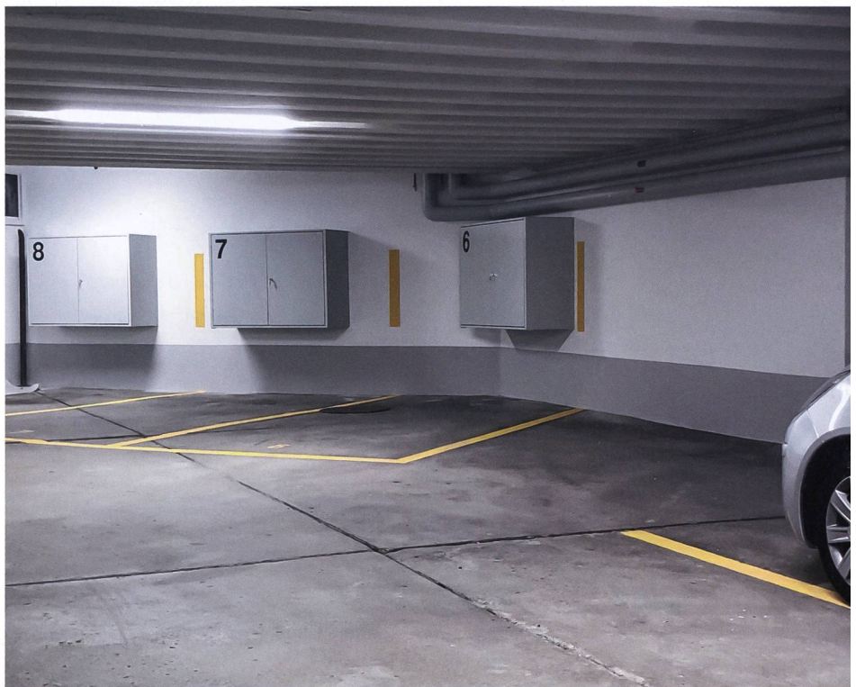
Die Baugenossenschaft Rotach liess die Tiefgarage ihrer Siedlung Triemli 3 sanieren. Die Erdüberdeckung, die nicht abgetragen werden konnte, machte eine Verstärkung mit Kohlenfaserarmierungen bei den Decken nötig. Die Bilder zeigen die Tiefgarage vor (oben) und nach der Sanierung.
