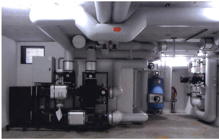
Die neue Wärmeübergabestation (Wärmetauscher) bei der Gewobag.
