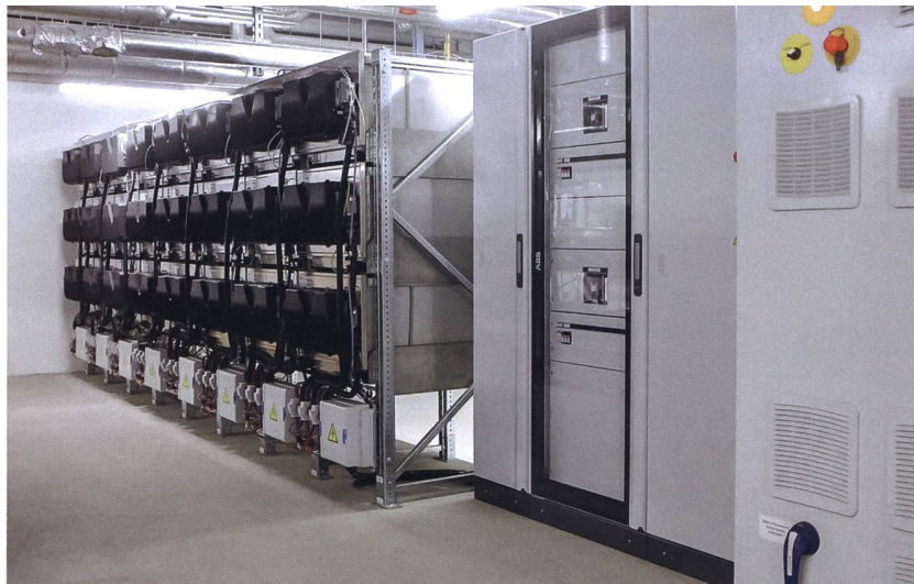
Salzschnmelzbatterien sind breit einsetzbar, auch in Wohngebäuden. Sie sind sicher und zuverlässig, derzeit aber teurer als Lithium-Ionen-Batterien (im Bild die derzeit grösste Anlage der Schweiz mit 22 Batterien in der Migros-Filiale Schlieren [ZH]).
