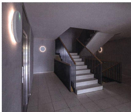
Begleitendes Licht im Treppenhaus
