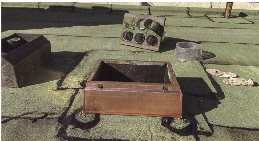
Qualitätsarbeit ist bei Flachdächern vor allem bei An- und Abschlüssen wie Lüftungen oder Geländerpfosten wichtig. Hier kommt es am häufigsten zu Feuchtigkeitsschäden.
