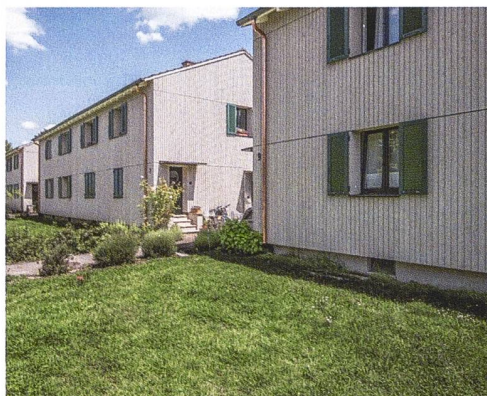
Hausfassaden zur Strassenseite. Für die energetische Sanierung wurde die gesamte Fassade gedämmt und mit vertikalen Holzlatten verkleidet.
