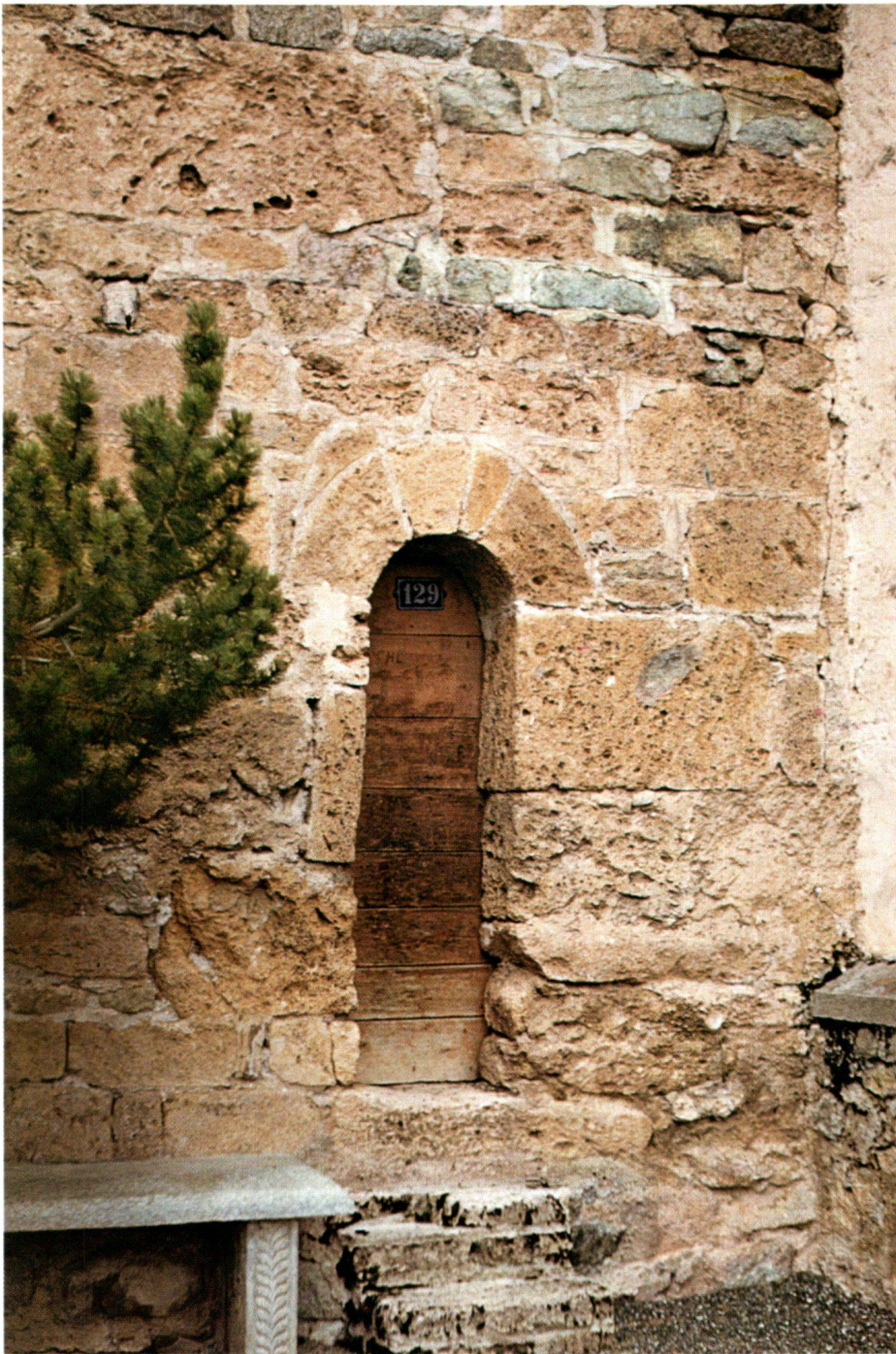
Abb. 1 Rauhwanke am Turm (11/12. Jh.) der alten Pfarrkirche St. Peter in Samedan
