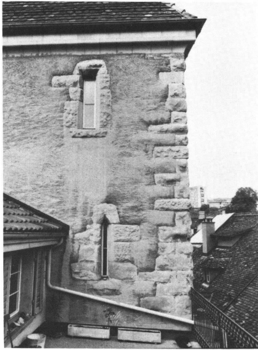
Abb. 9: «Grimmenturm» (Spiegelgasse 29): Geradezu ein Leitfossil für das letzte Drittel des 13. Jahrhunderts sind die spitzwinkligen oder geraden Abschluss aufweisenden Lichter.
