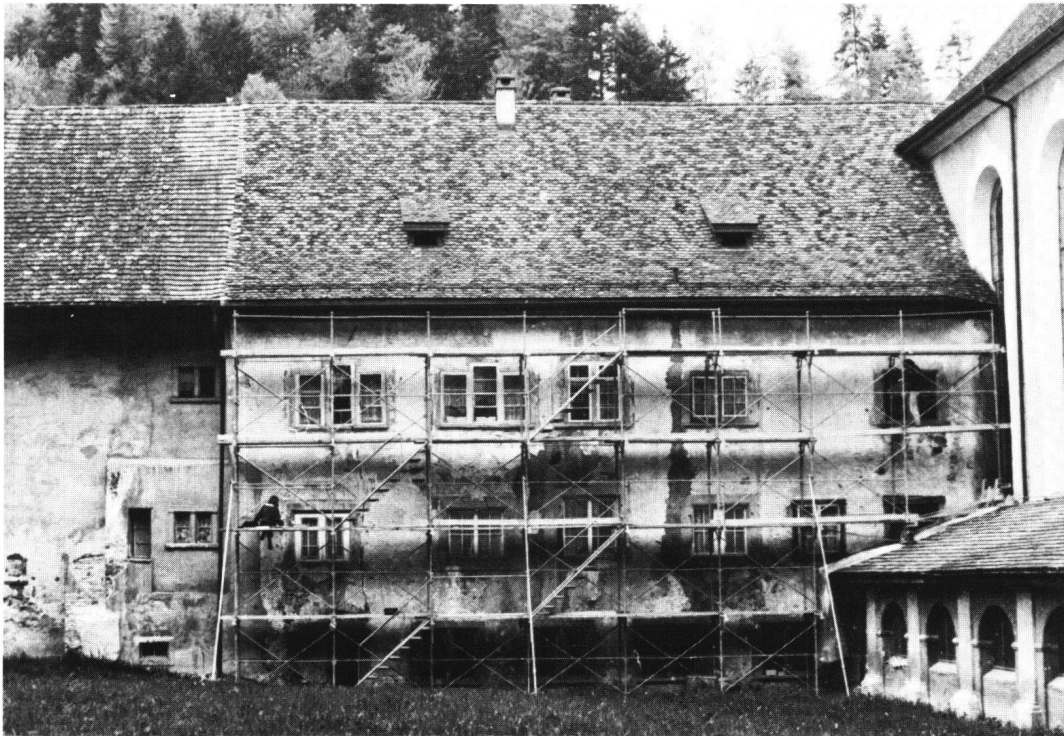
Abb. 8 Eine Lehrbaustelle der Restauratorenfachklasse im Kloster Fischingen TG. Hoffassade des Abt-Brunner-Baus mit originalen Putz- und Polychromieteilen des 16. Jahrhunderts. Zustand während der Voruntersuchung 1982.
