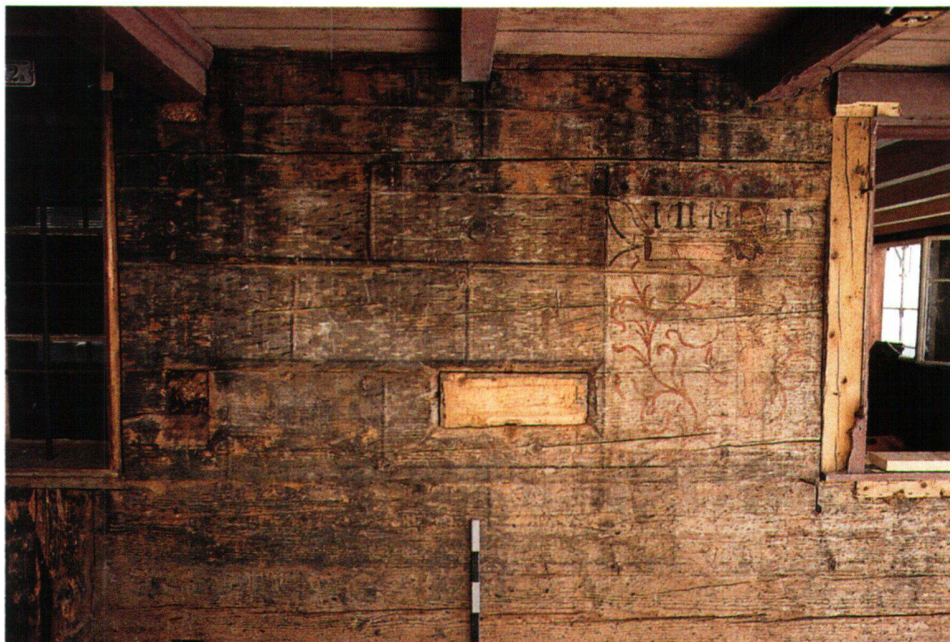
Abb. 16 Menzingen, Hauptstrasse 6: Quaderimitation und Kruzifixus an der Westfassade auf der Höhe des ersten Obergeschosses, Blick nach Osten. In der Mitte die originale Fensterluke.
