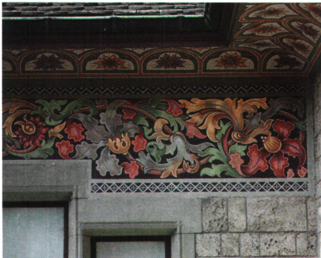
Abb. 17 Rankenfries in der Art spätgotischer Flachschnitzfriesen an der Fassade des Schweizerischen Landesmuseums Zürich, gemalt von Christian Schmidt & Söhne, 1897, teilweise rekonstruiert 1979–1984.
