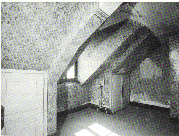
Fig. 11 Vue d'intérieur du Château de Prangins en travaux (salle 1205), 1985. Photographie d'Henri Germond.
