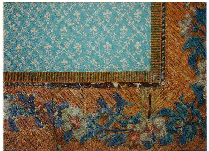
Abb. 18 Der 1967 angebrachte Ersatz für die grüne Unitapete sowie Originalbordüre mit abblättrender Malschicht, Situation 2006, Neue Burghalde Lenzburg.
