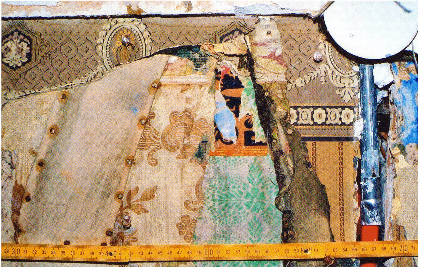
Abb. 1 Einige von ursprünglich acht Tapetenschichten in einem Raum des Hattstätterhofs Basel, Situation 2005.
