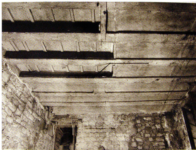
Fig. 5 Vue du plafond avant le début des travaux en 1960.
