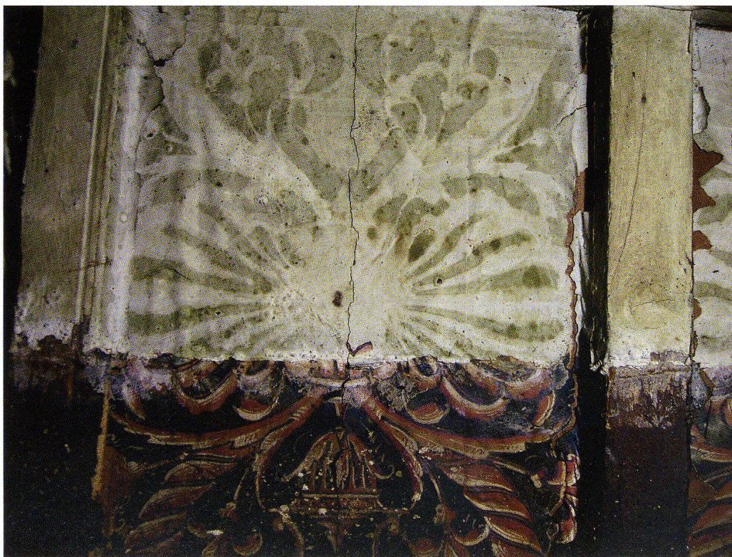
Fig. 3 Détail de l'état de conservation du plafond avant l'intervention.
