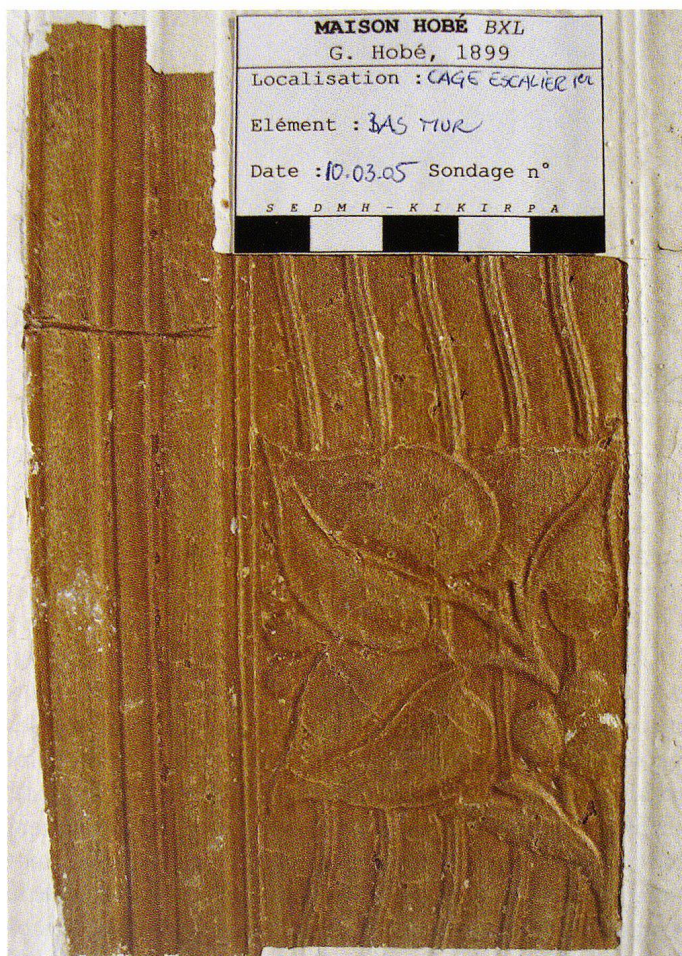
Fig. 8 Dégagement de la finition originale du papier peint recouvrant le bas des murs de la cage d'escalier.
