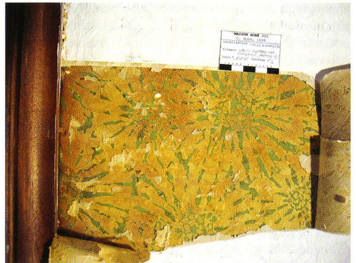
Fig. 11 Sondage mettant au jour le papier original du plafond de la salle à manger du premier étage.
