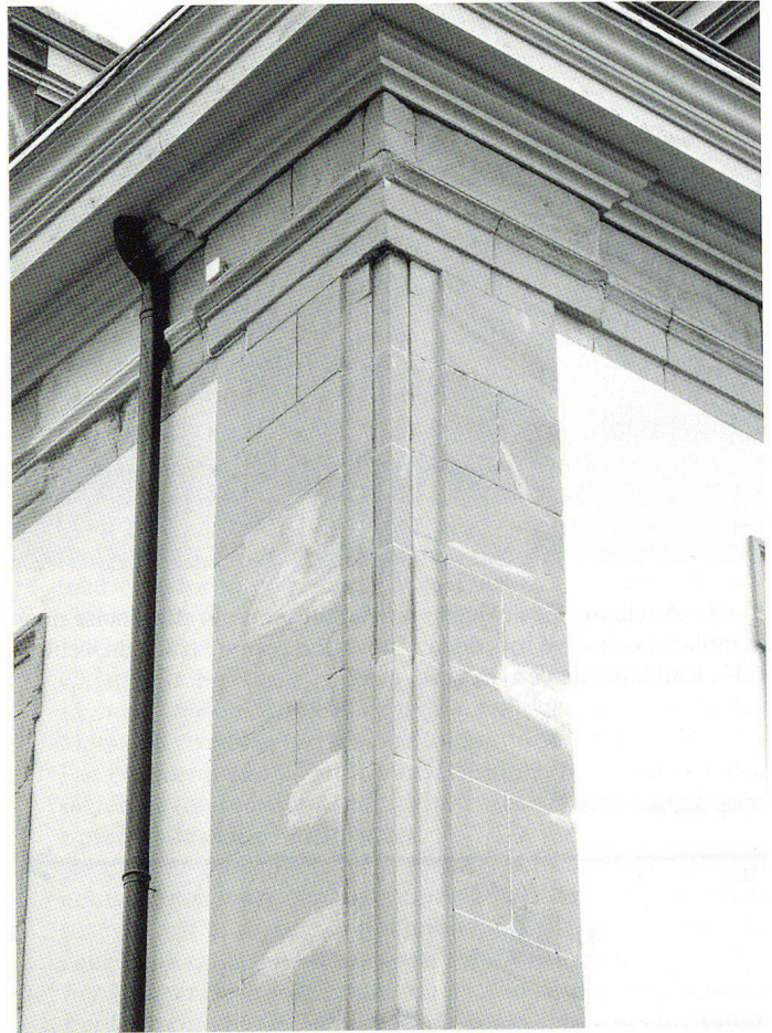
Fig.6 Ancienne Ecole de chimie de Lausanne, détail d'une chaîne d'angle après « rénovation douce ».
