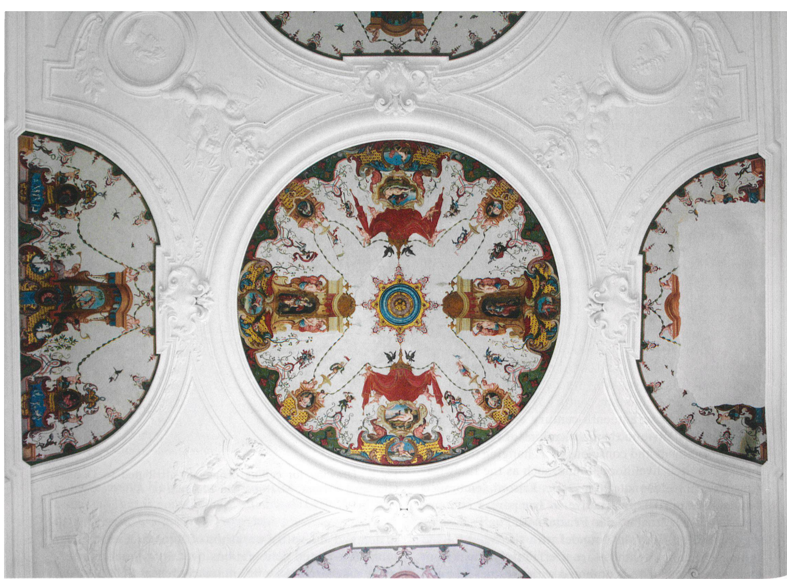
Fig. 9 Ceiling of the Kaisergemach, Schloss Idstein, Hessen. Photograph courtesy of Hans Michael Hangleiter.
